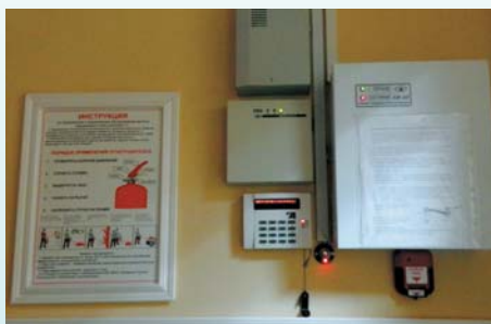
Система пожарной сигнализации
