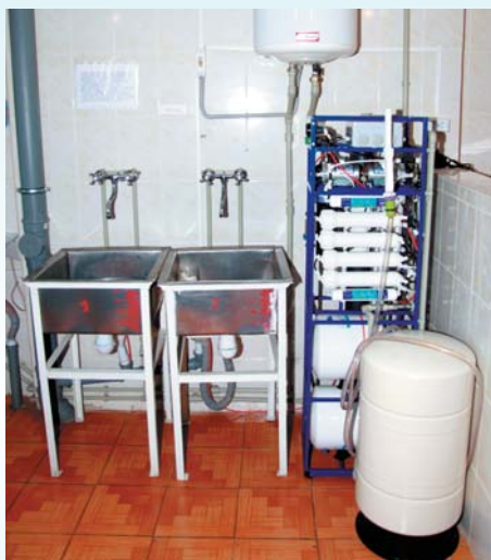
Система очистки воды
